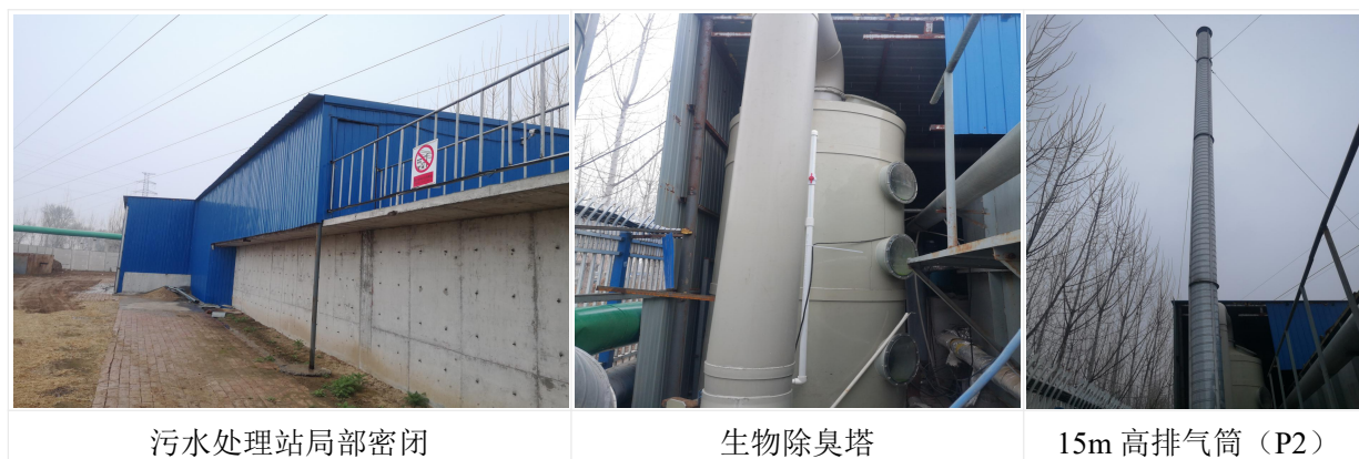
图 4-4 厂区污水处理站废气治理设施图片
