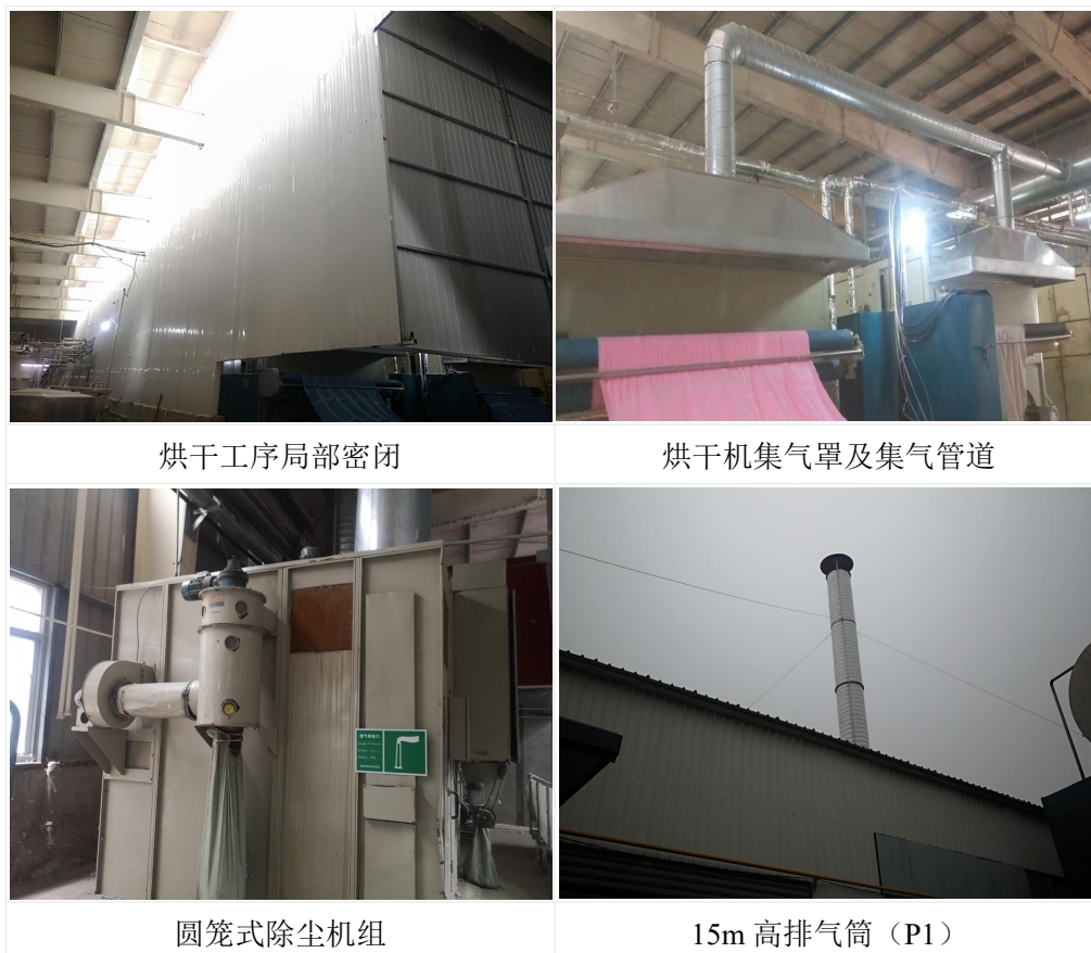
图 4-3 烘干车间废气治理设施图片
