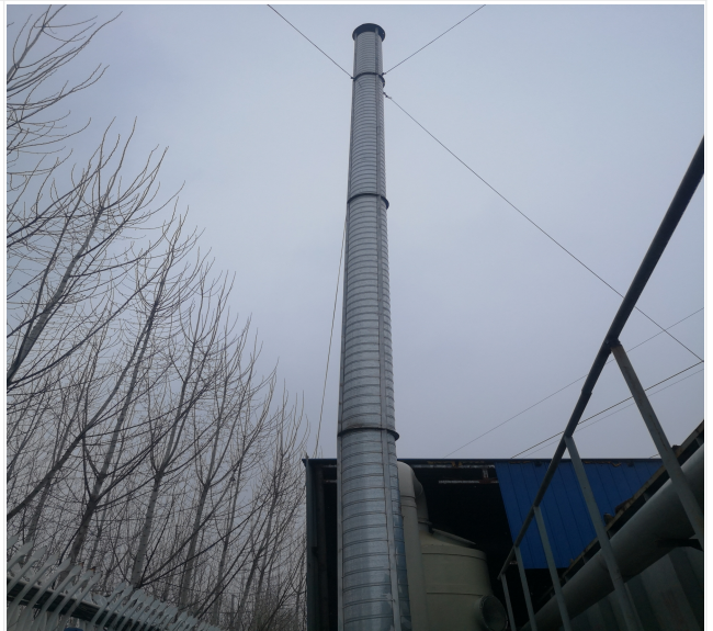
15m 高排气筒
