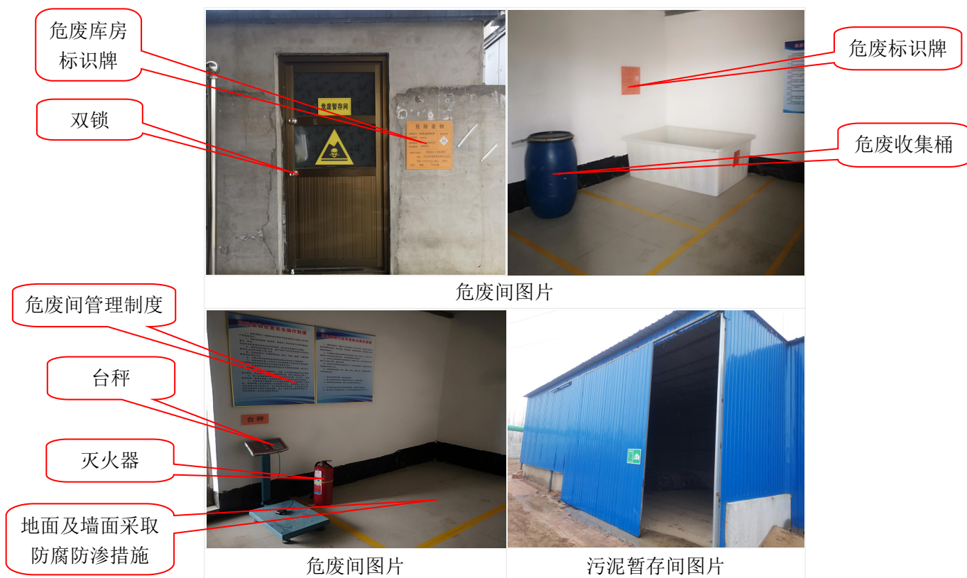
图 4-6 项目危废间 2#及污泥暂存间图片
