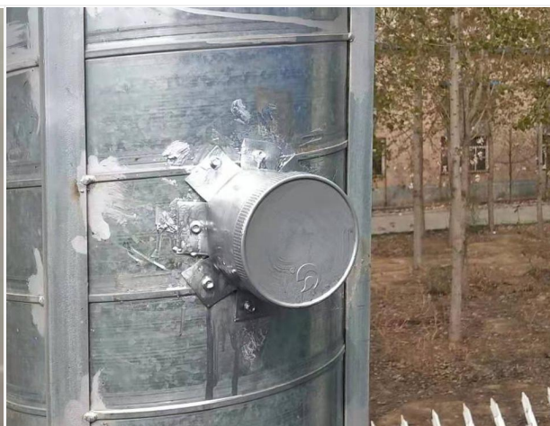
生物除臭塔出口采样孔
