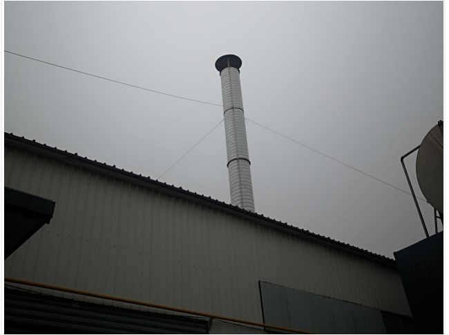
15m 高排气筒
