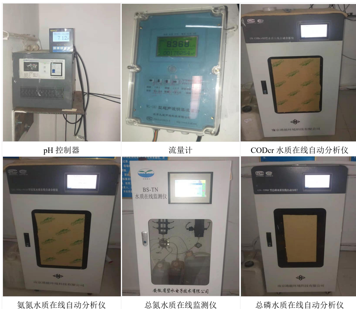
图4-8 污水处理站在线监测设备图片
