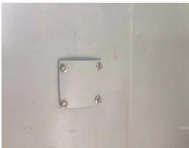
生物除臭塔进口采样孔
