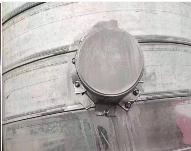
圆笼式除尘机组出口采样孔
